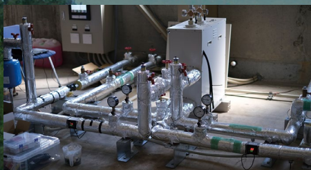
地中熱ヒートポンプ実験システムの外観
