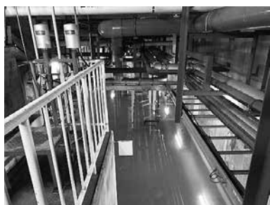
写真6-26 環境安全センター地下室が浸水、 水処理を停止 (平成30年7月)
